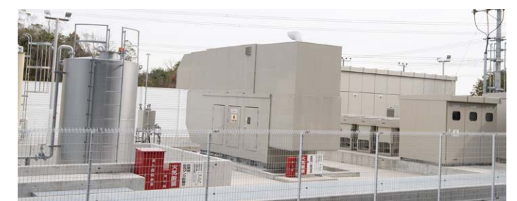
非常時の電源供給：物流拠点に設置の非常用発電装置が電気を72時間供給
